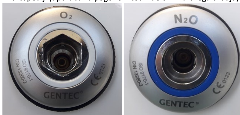
Slika 3: Končna spojka instalacij kisika (levo) in dušikovega oksidula (desno).
